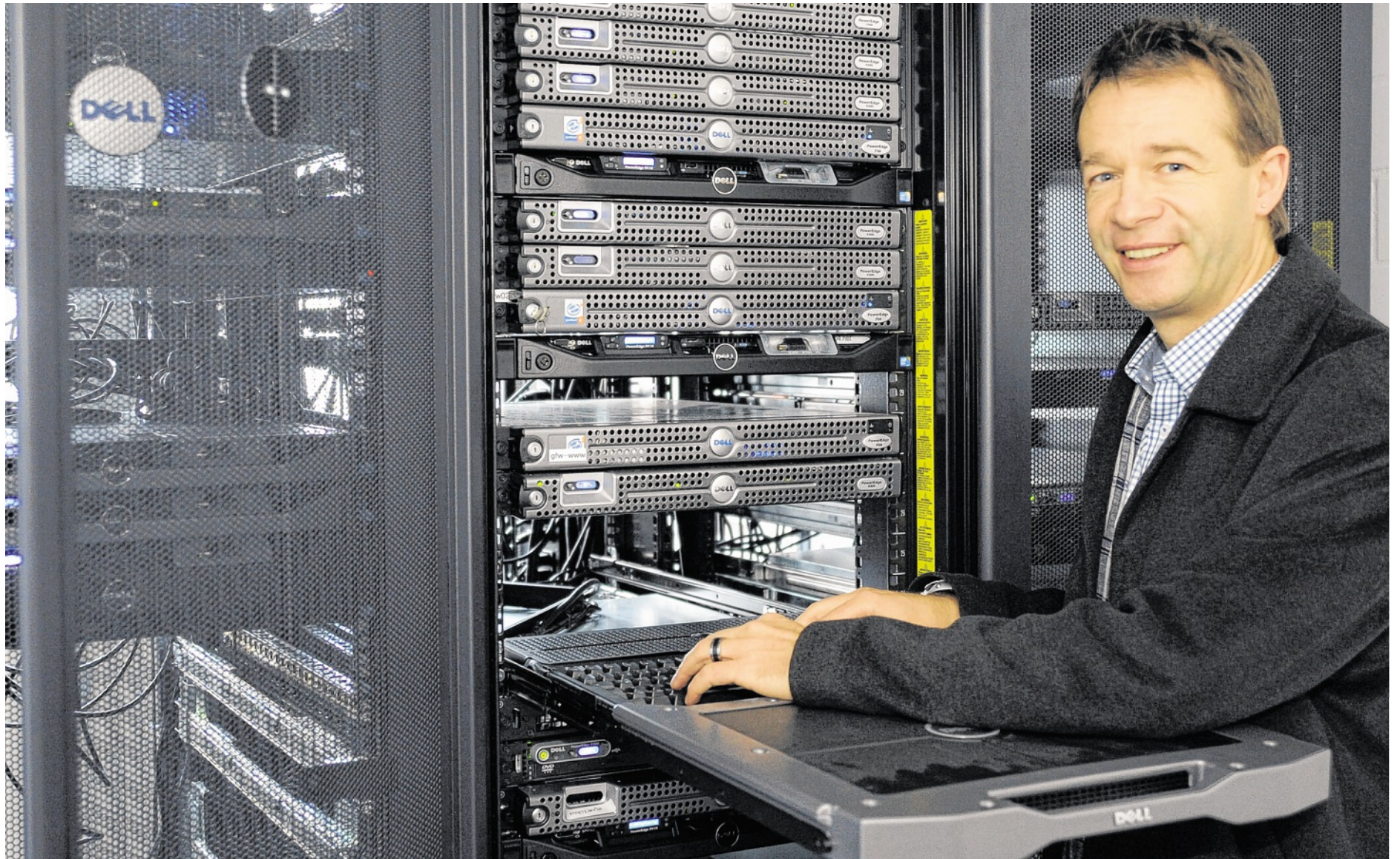
Andreas Scher zeigt im neuen Firmensitz von Planet IC die Schränke, die Platz für insgesamt 3000 Server bieten.
